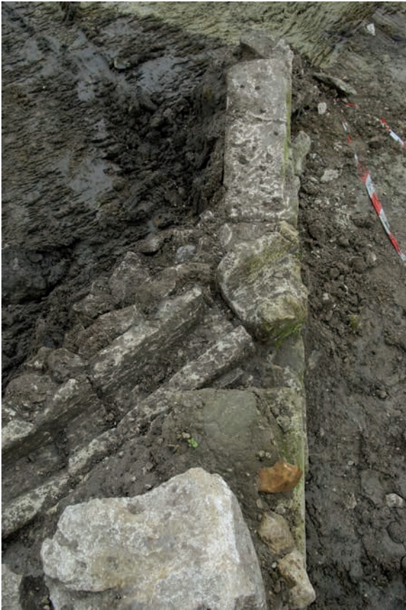
Cl. 166 Vue zénithale de la mise en œuvre entre le caniveau et la maçonnerie 2041
